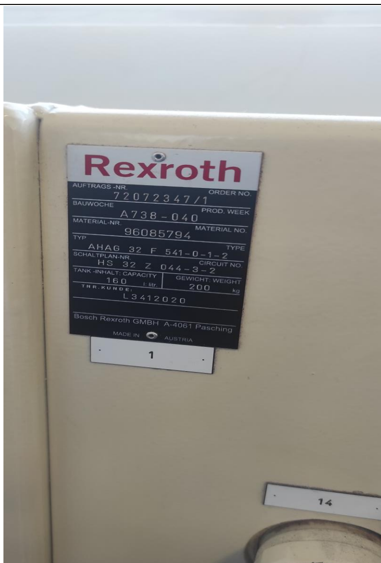
Plaque signalétique centrale hydraulique actuelle
